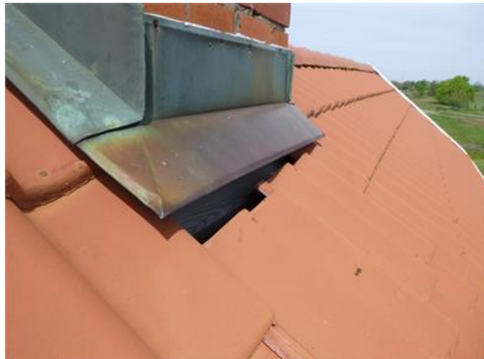
Lösa nerglidna pannor kring skorstenen
