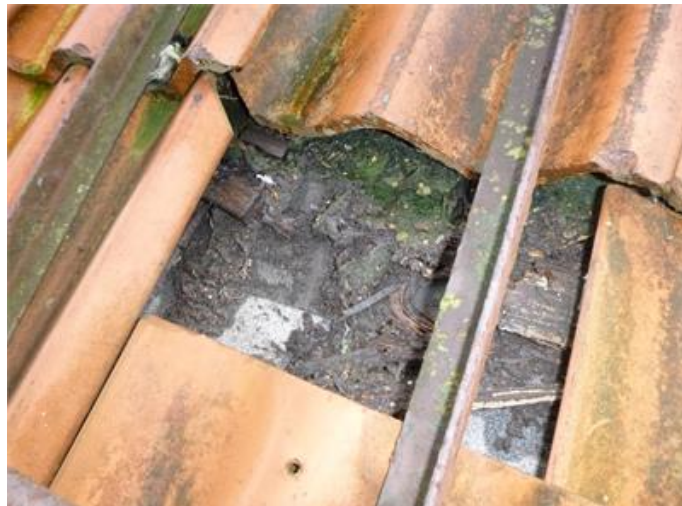
Kraftiga rötskador i läkt utmed hela takstegen
