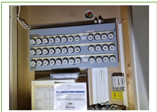
Bild 3: Äldre el-central utan jordfelsbrytare
