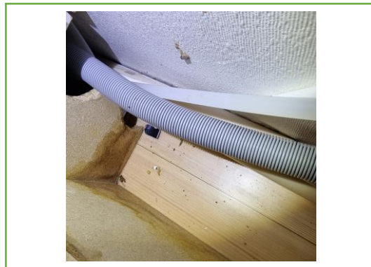
Bild 2: Fuktmärke i diskbänkskåp. Torrt vid kontroll
