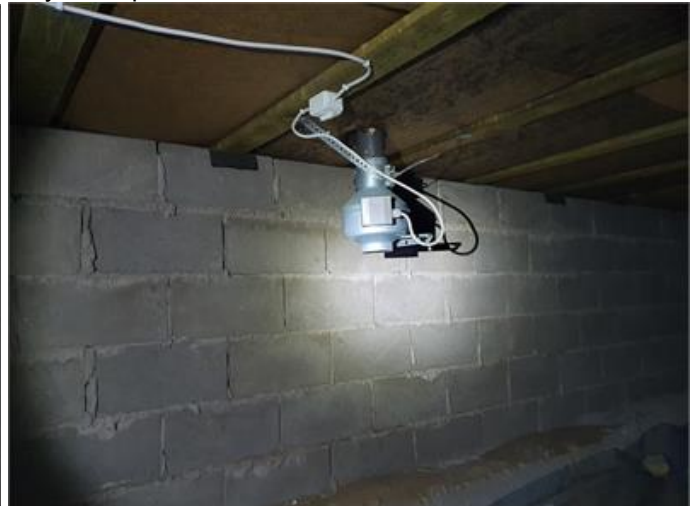
Krypgrund med installerad undertrycksventilation
