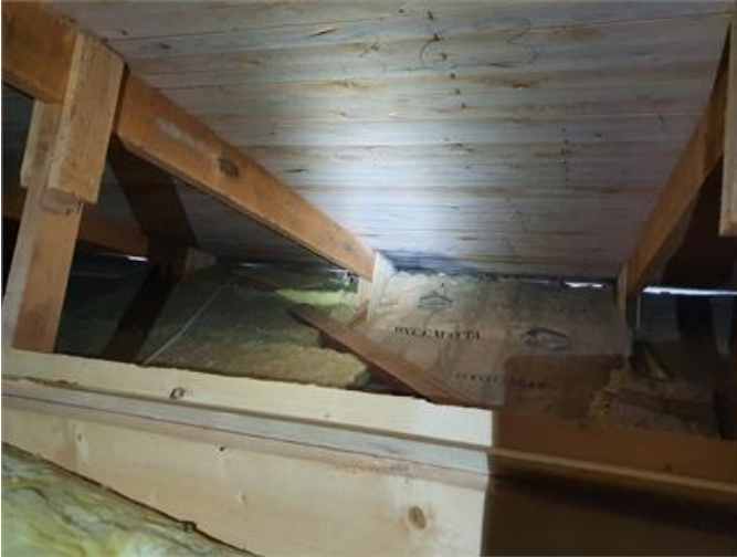
Mikrobiell påväxt på underlagstaket/vinden
