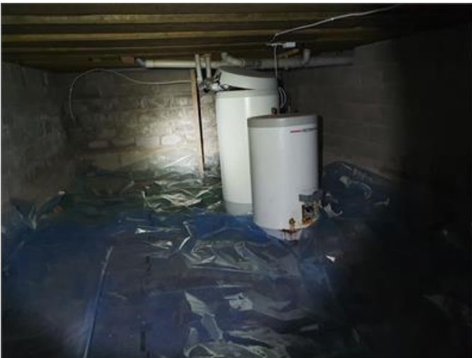
Krypgrund med installerad varmvattenberedare
