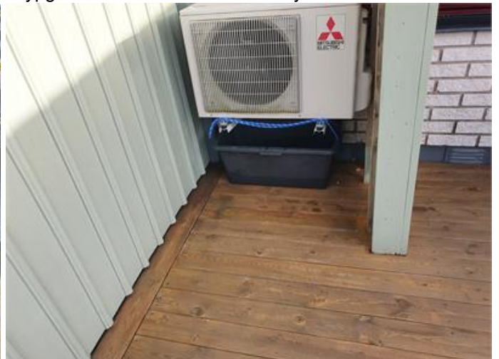
Med fördel samlas kondensvatten från luft/luftvärmepumpen upp via balja/hink
