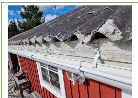
Bild 5: Skador på takpannor
