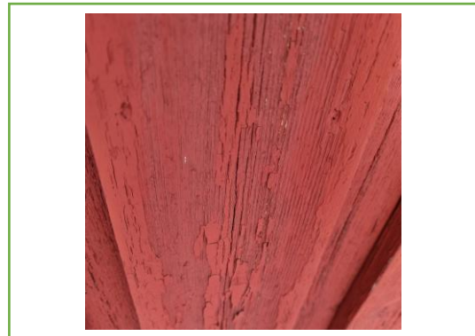
Bild 10: Delar av fasad i behov av målning.
