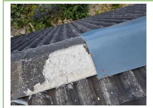
Bild 8: Skador på nockpannor.
