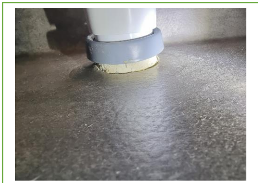
Bild 1: Otätt rör genomföring i badrum.
