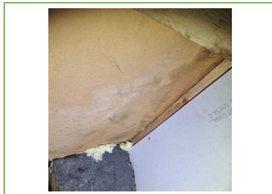
Bild 2: Fuktmärken trossbotten i grund. Detta är under befintligt kök där det varit en fuktskada 2014.
