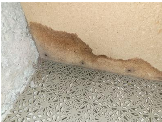
Fukt i vägg på källarplan.
