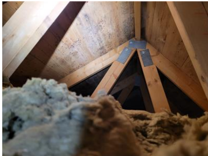
Mikrobiell påväxt på underlagstak.
