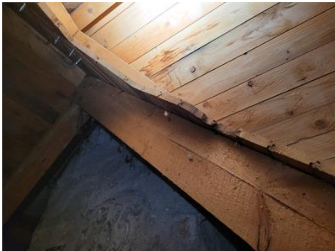
Fuktfläck på underlagstak.
