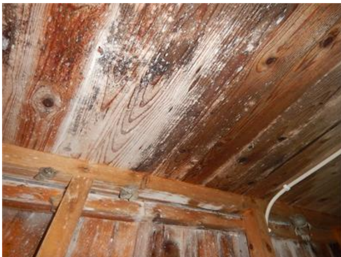
Mikrobiell påväxt på underlagstak vind.
