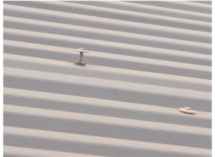
Lösa spikar i plåttaket.
