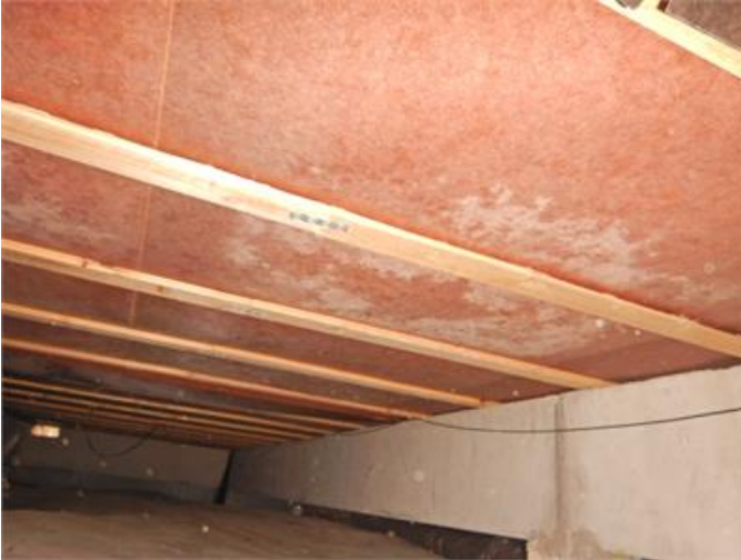
Mikrobiell påväxt noteras på undersidan av blindbotten.
