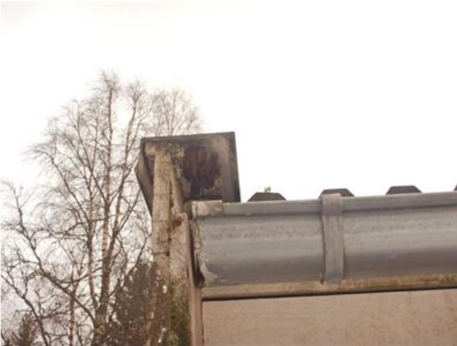
Ändstycken på överliggare vindskivor rötskadade.
