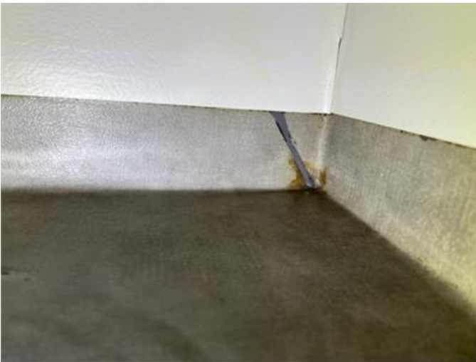
Pos 3. Stående mattskarv på vägg är ej svetsad och otätheter förekommer i mattskarv på på golv
