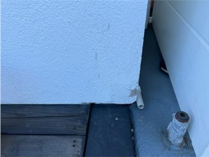
Pos 1. Mindre skador förekommer i fasaden intill entrén.
