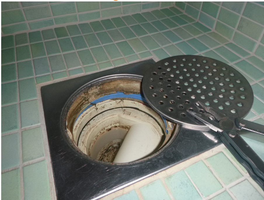
Klämring ej fixerad i våg mot golvbrunnen. Golvbrunn från byggnadsår.
