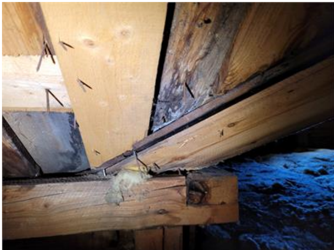
Fuktfläckar på underlagstak.
