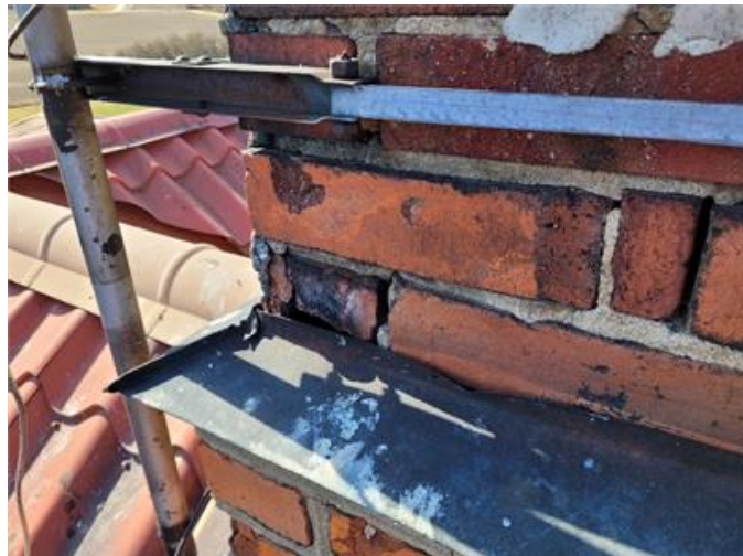
Skorsten med underhållsbehov.
