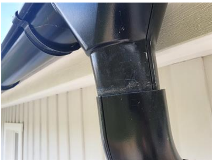
Stuprör bör åtgärdas.
