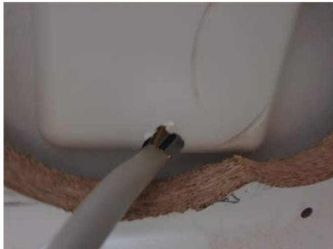
Öppen elinstallation under diskbänk
