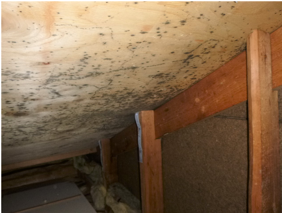
Lokal missfärgning på boardskiva intill gavel, vindsutrymme.
