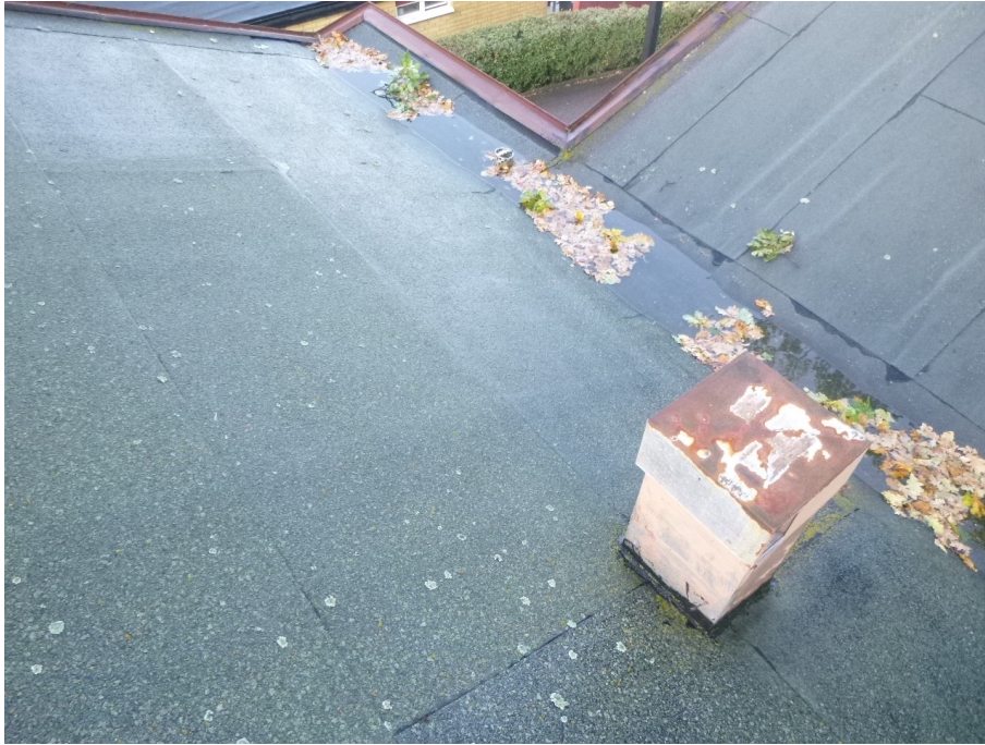
Kvarstående vatten intill takavlopp samt rostanvisning i ventilationshuv.
