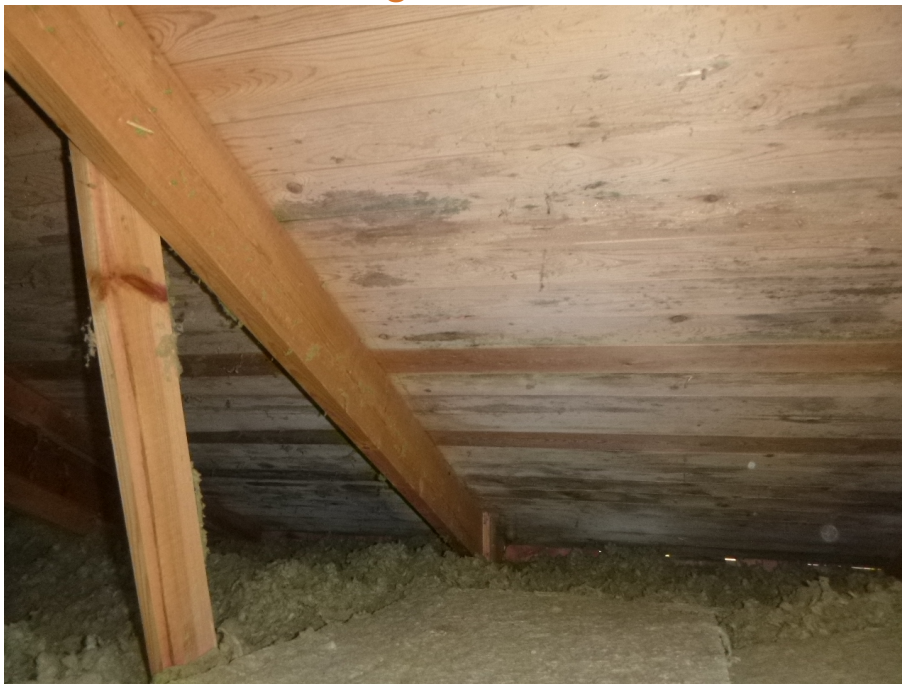
Mikrobiell påväxt underlagstak, vindsutrymme.
