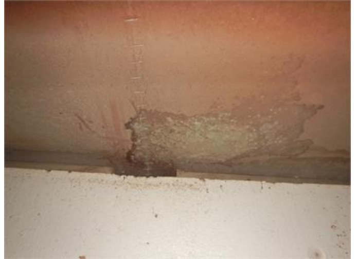
Lokal påväxt innanför ventil
