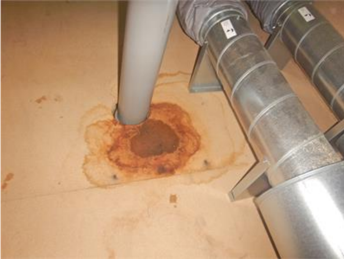
Fuktskadad spånskiva under avloppsrör på sidovind.
