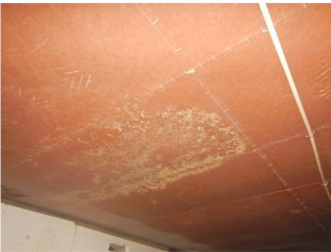
Lokal påväxt på undersida av bjälklag under kök.
