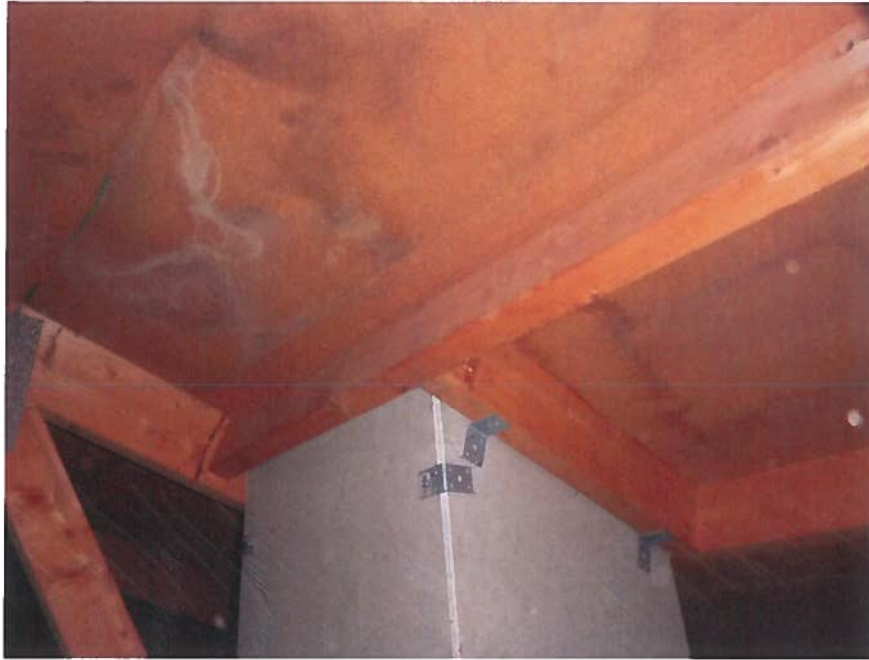
Missfärgning på boardskivor intill inbyggnad/genomföring av kaminrör.
